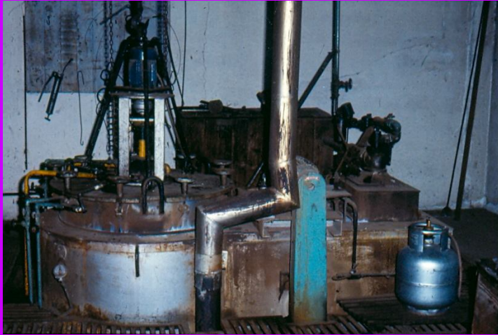
Instalación de nitruración
