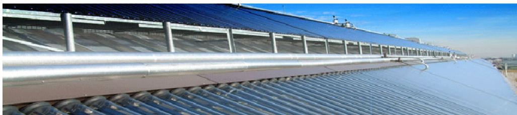
Figura 3.7: Colectores con tubos evacuados.
