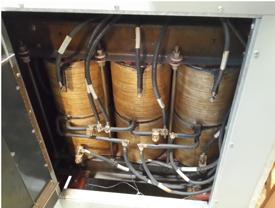
Figura 1: Transformador trifásico de tres arrollamientos a ser ensayado.
