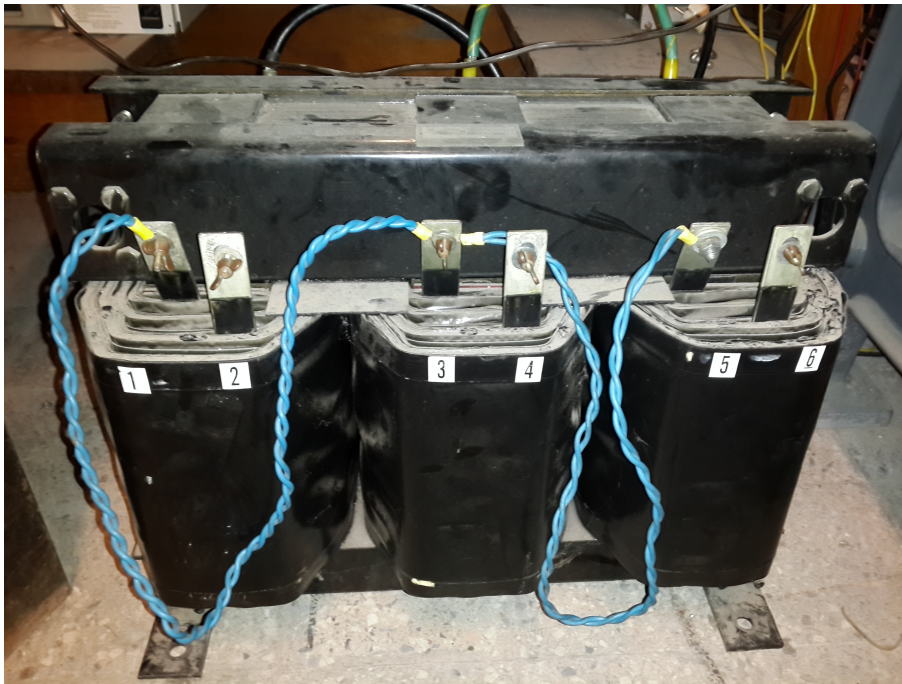
Figura 2: Transformador trifásico, para interconectar el regulador con el transformador a ser ensayado.
