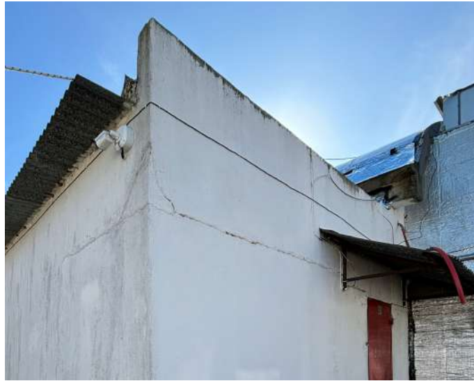
Figura 2: Continuación de la fisura - Esquina Bóveda D
