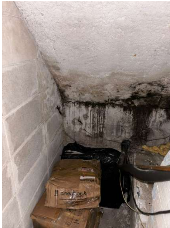
Figura 10: Humedad - Ático de la Bóveda A
