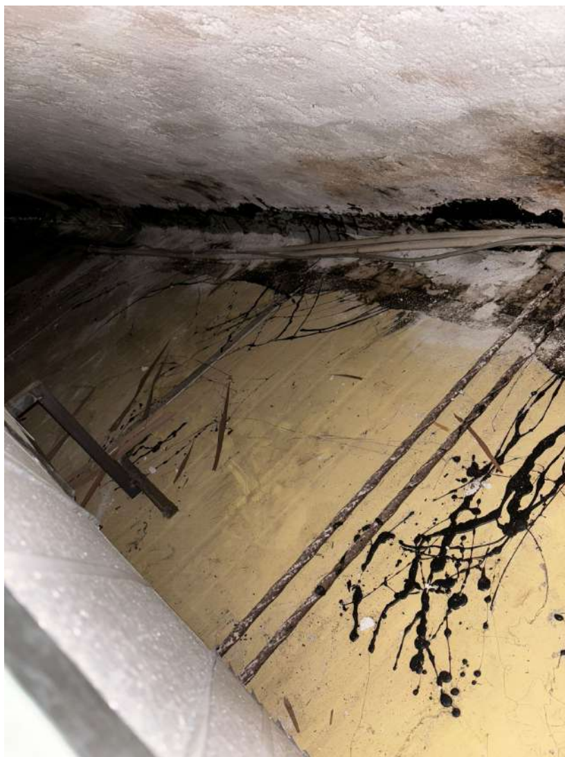
Figura 8: Humedad - Ático de la Bóveda A
