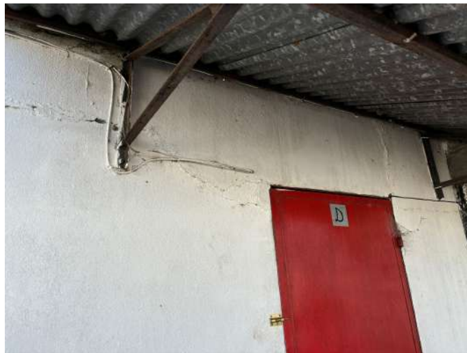
Figura 1: Fisura en el marco de la puerta - Bóveda D
