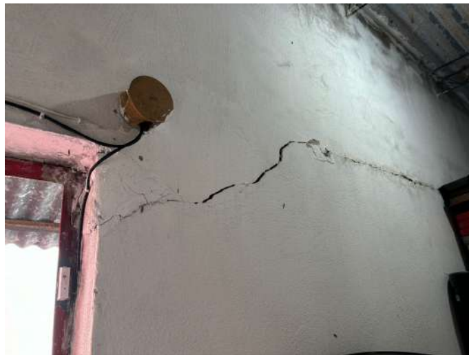
Figura 3: Nacimiento de la fisura - Parte interior del Bóveda D
