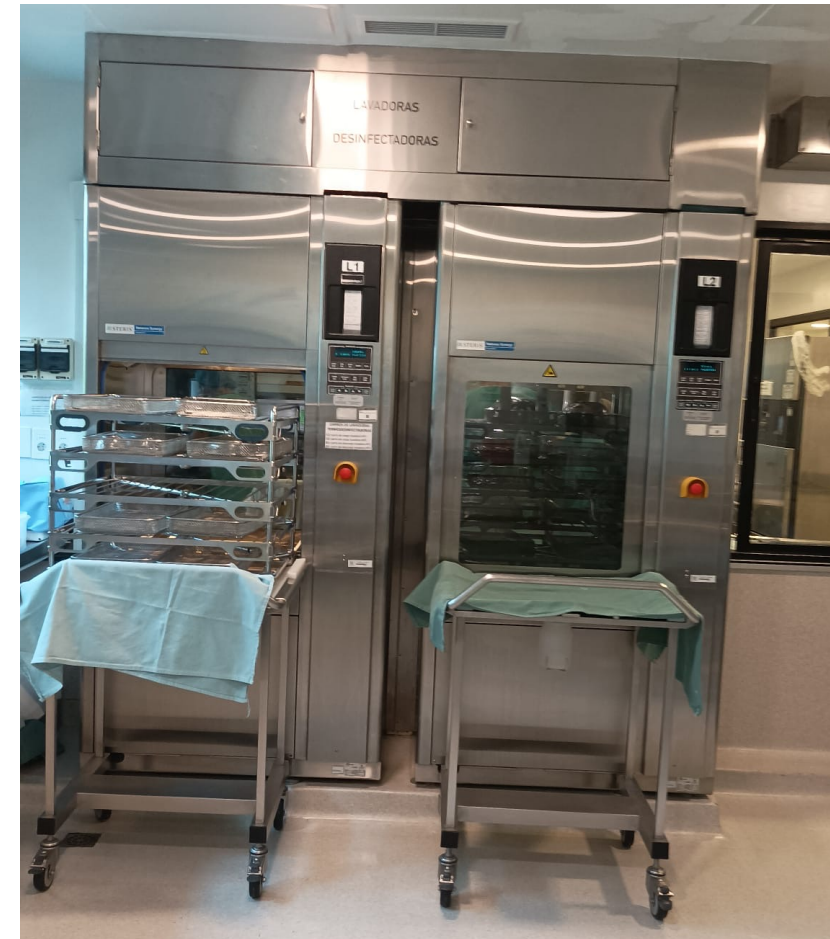
Equipamiento de central de esterilizaciones
