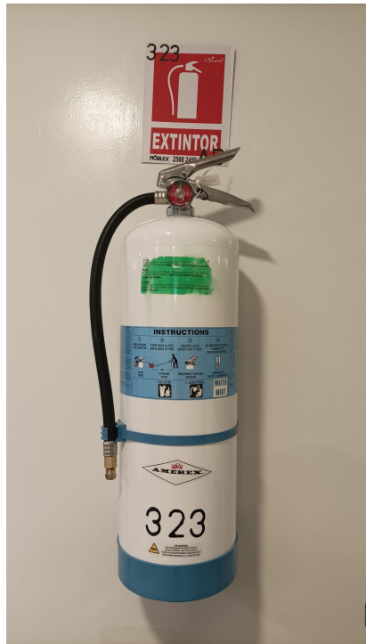
Extintores de agua desionizada
