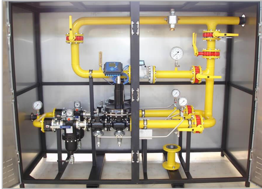
Estación de Regulación y Medición ( ERM )
