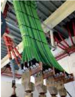
Cables afectados por el CPR.
