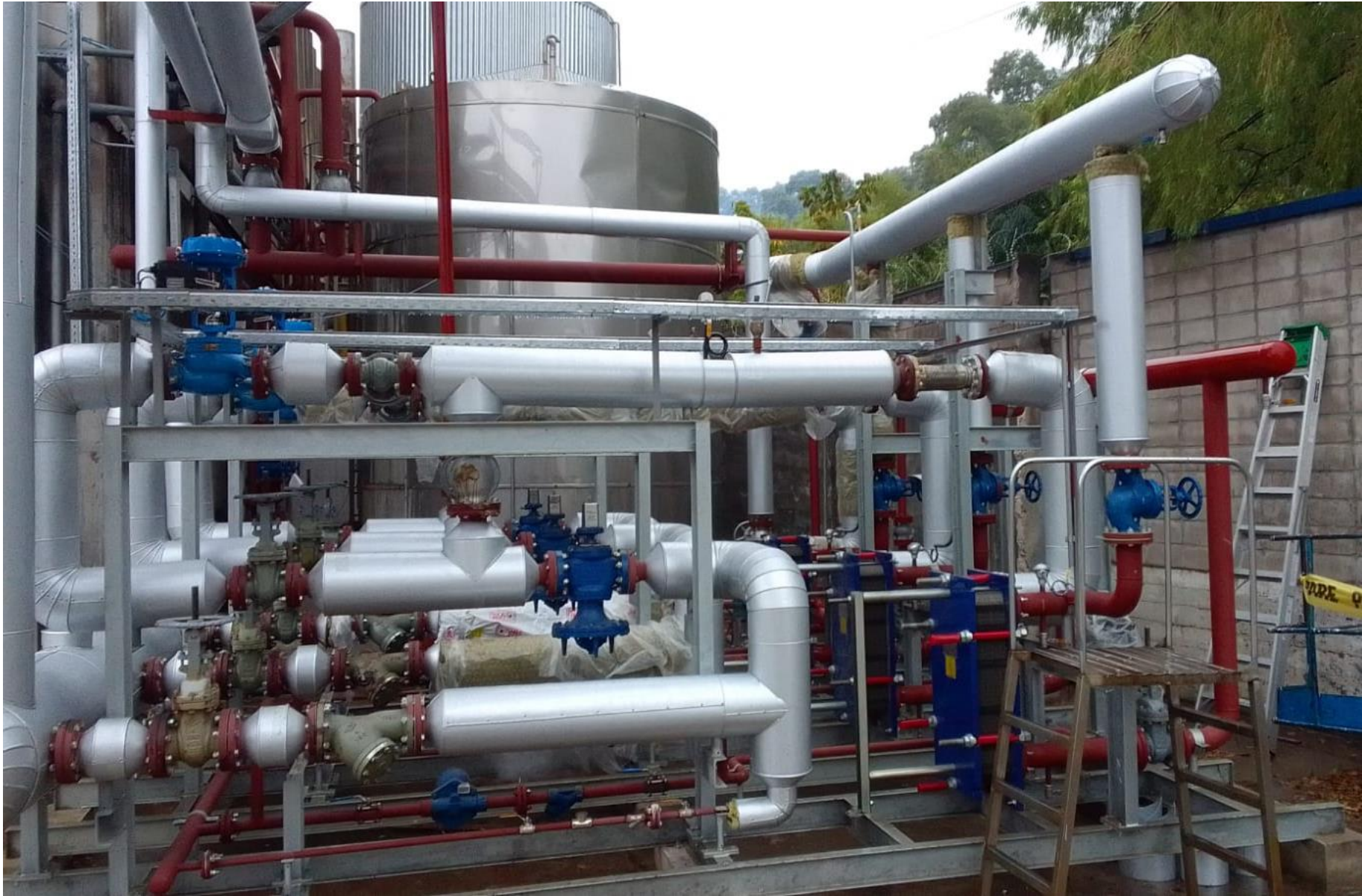
Ej: Sistema de generación de agua caliente con intercambiador placas planas (agua/vapor).
