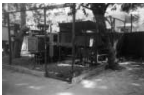
Fig. B36: Subestación de exterior.
