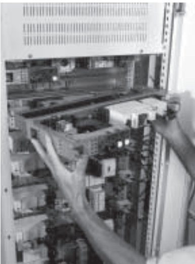
Fig. E51: Cuadro de distribución con unidades funcionales desconectables.
