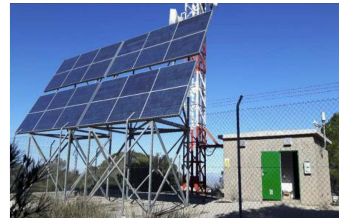
Instalación fotovoltaica aislada con baterías de plomo ácido, "Hybrid and Intelligent Energy Storage Systems in Standalone Photovoltaic Applications", Iván Sanz PhD dissertation
