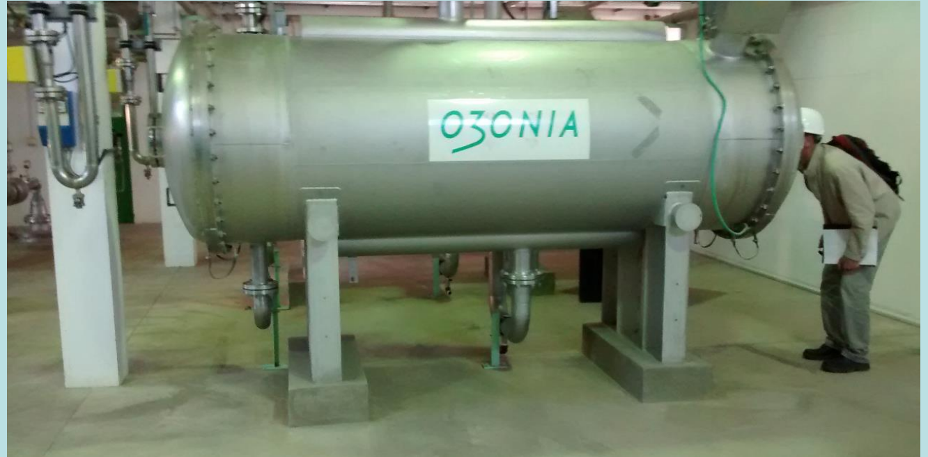
Aguas Cordobesas- Planta Suquía- Sala generación de ozono
