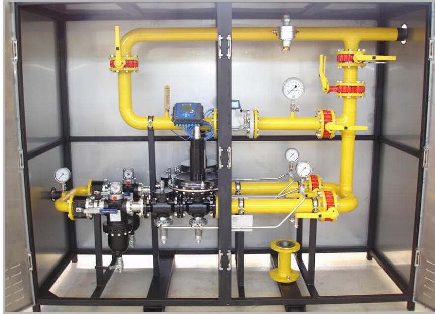
Estación de Regulación y Medición ( ERM )
