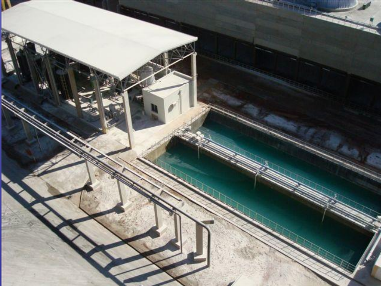
Água de lavagem da torre
