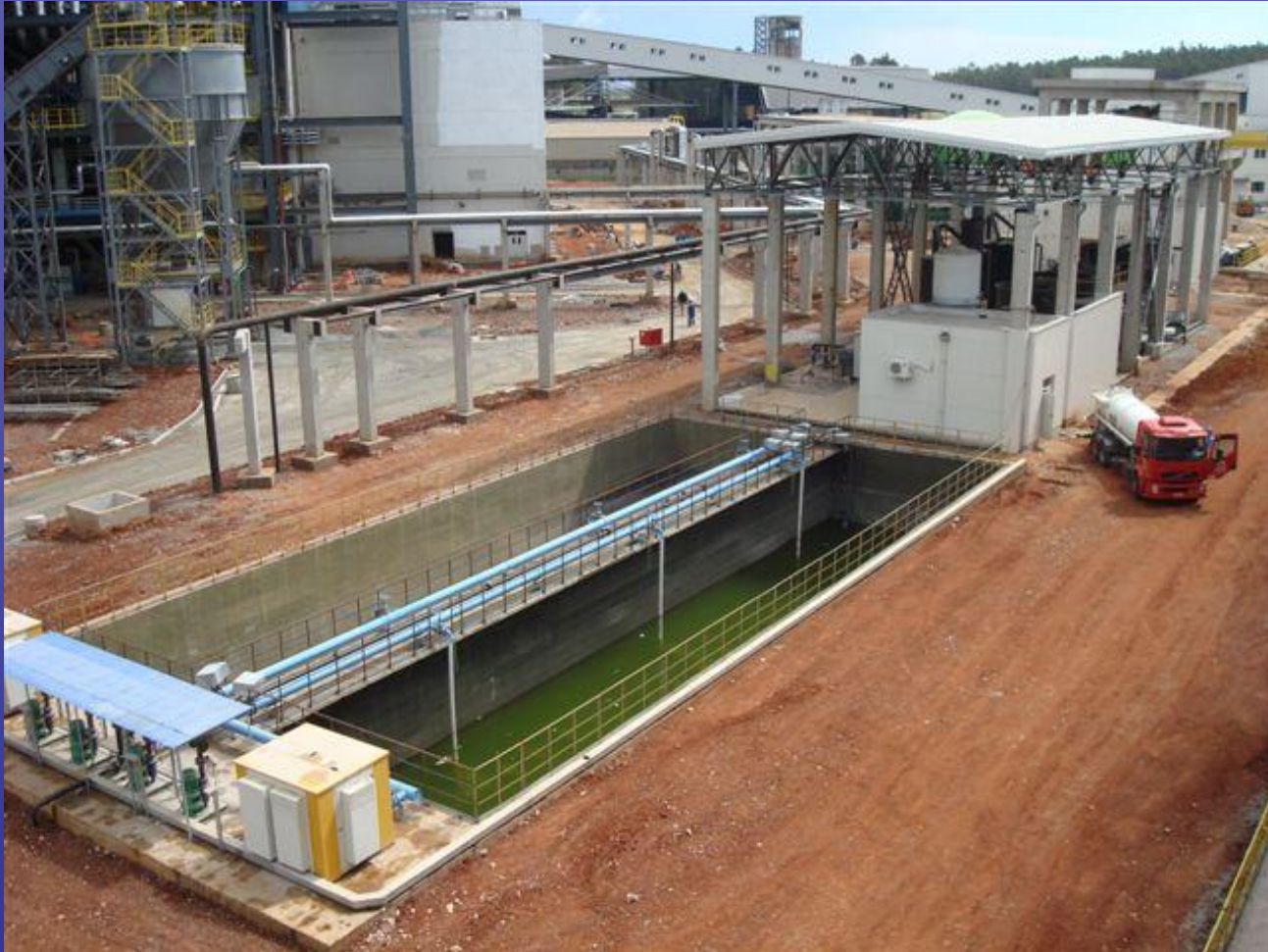
Água do circuito de carvão
