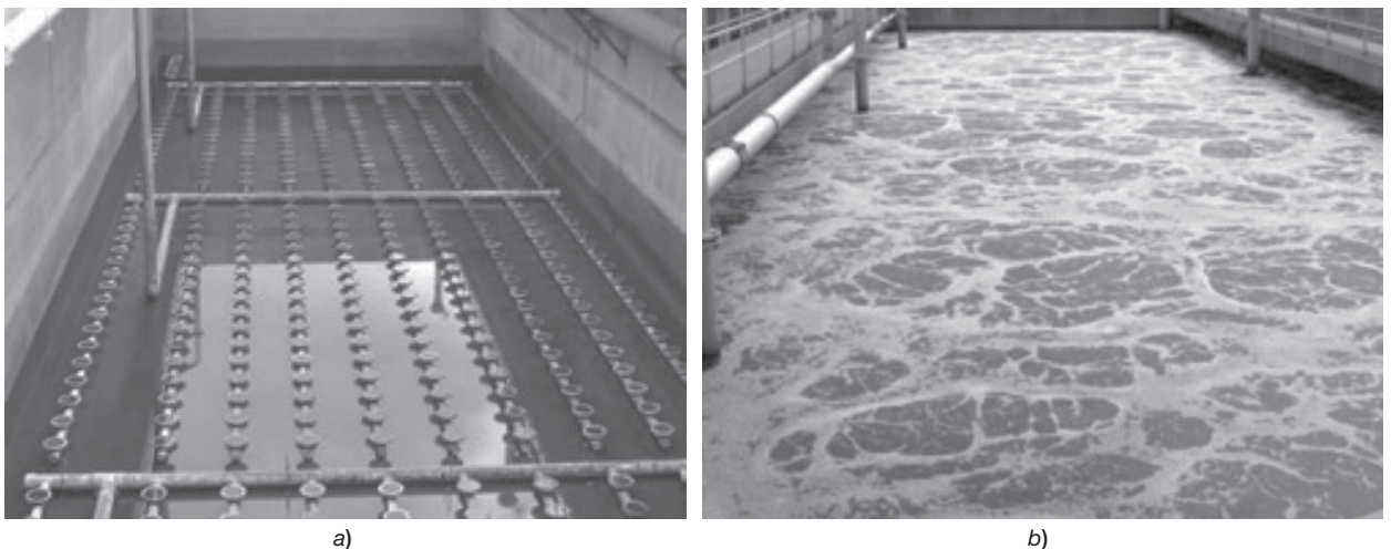
Figura 11.18 Difusores de poro fino a) Difusores de poro fino en el fondo de cuencas de aireación rectangulares. b) Difusores de poro fino en operación en la misma cuenca de aireación.
