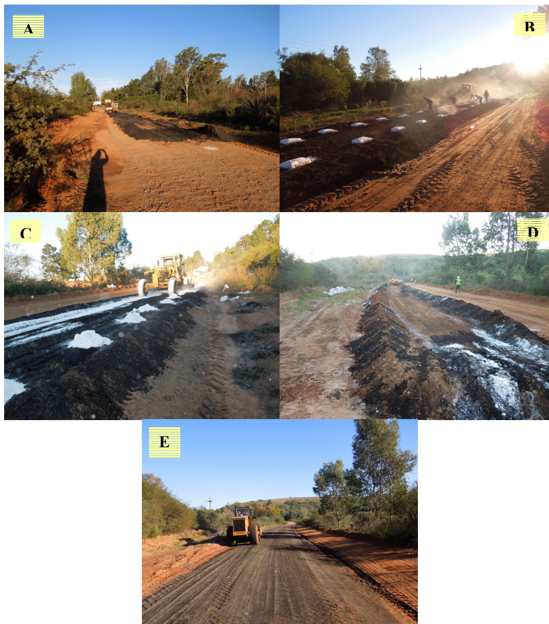
Figura 5.10. Etapas de Construcción del Tramo Experimental Unicapa del Camino a la Piedra Pintada
