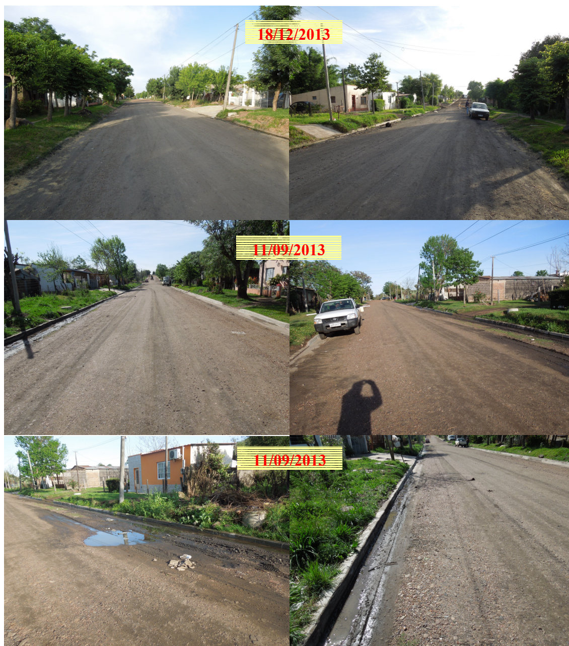
Figura 4.11. Condición Funcional del Tramo Experimental de la Calle Melo de Bella Unión en los Monitoreos Posteriores a su Construcción
