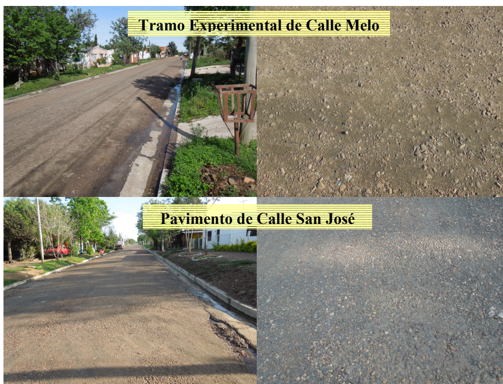
Figura 4.12. Condición Funcional Comparativa del Tramo Experimental de la Calle Melo y el Pavimento de la Calle San José
