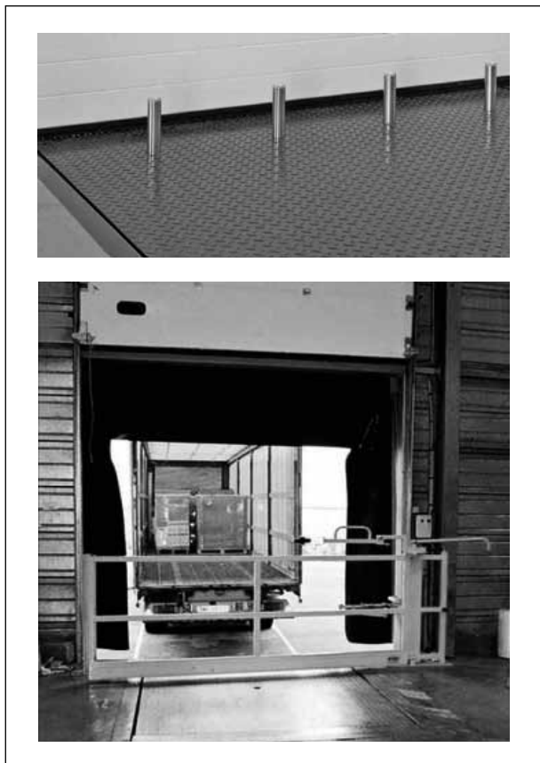
Figura 30. Rampa con bulones extraídos y barrera metálica
