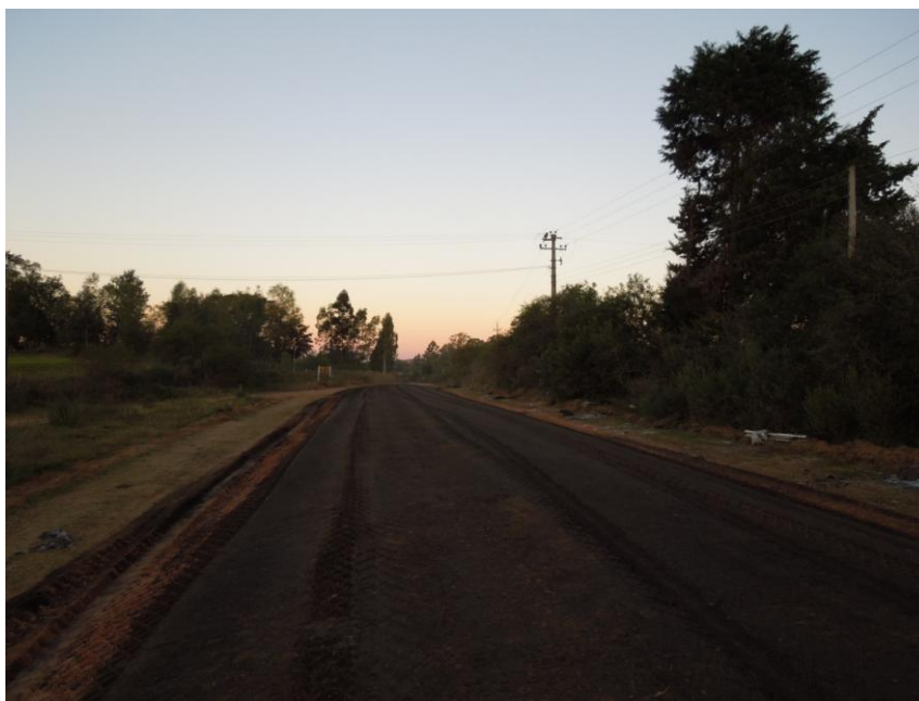
Figura 5.13. Condición del Tramo Experimental con Capa de Recargo del Camino a la Piedra Pintada al Finalizar la Obra de Construcción
