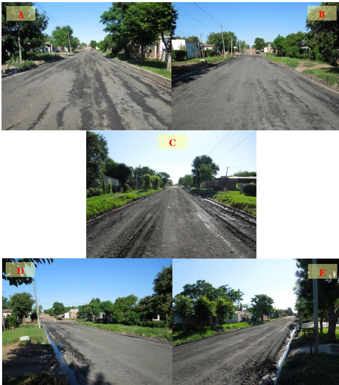
Figura 4.10. Condición Funcional del Tramo Experimental de la Calle Melo de Bella Unión Inmediatamente Después de su Construcción
