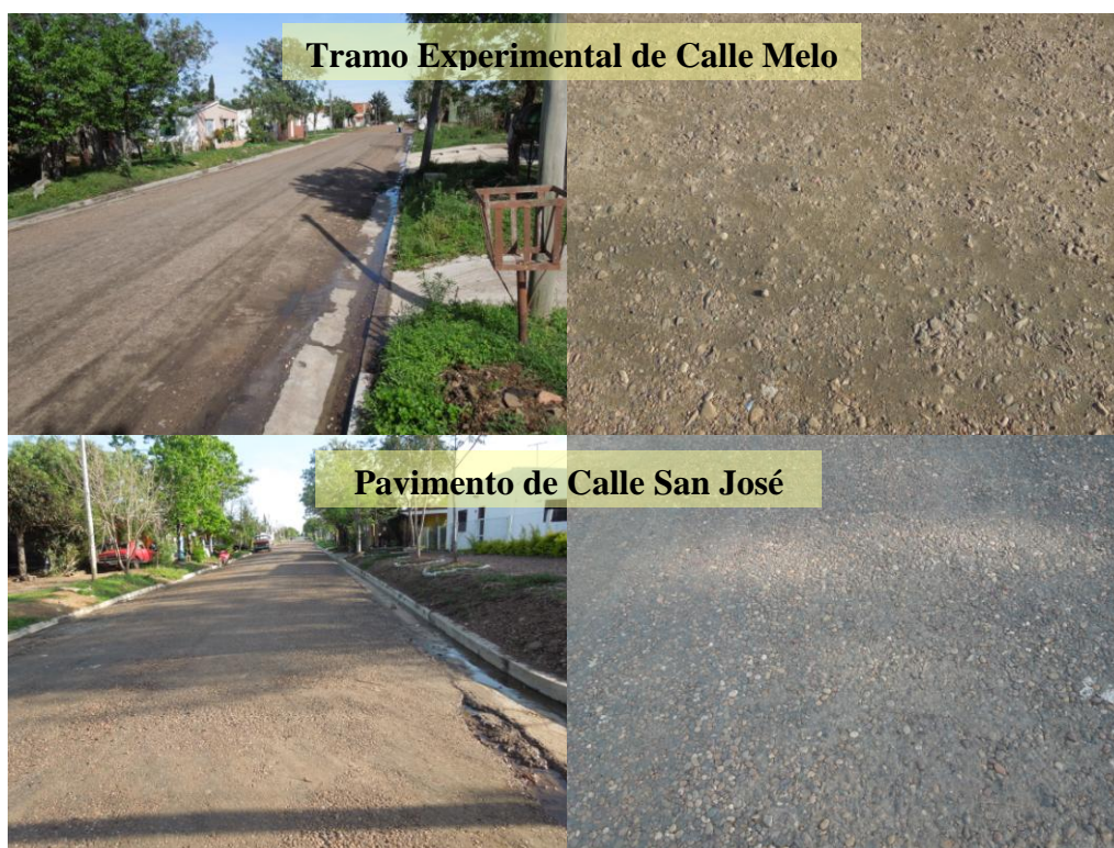
Figura 4.12. Condición Funcional Comparativa del Tramo Experimental de la Calle Melo y el Pavimento de la Calle San José
