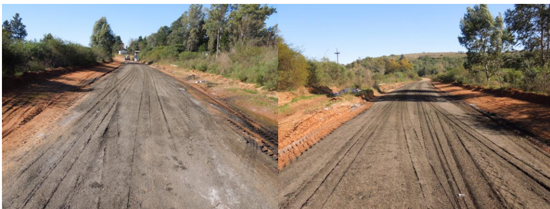
Figura 5.11. Condición del Tramo Experimental Unicapa del Camino a la Piedra Pintada al Finalizar la Obra de Construcción
