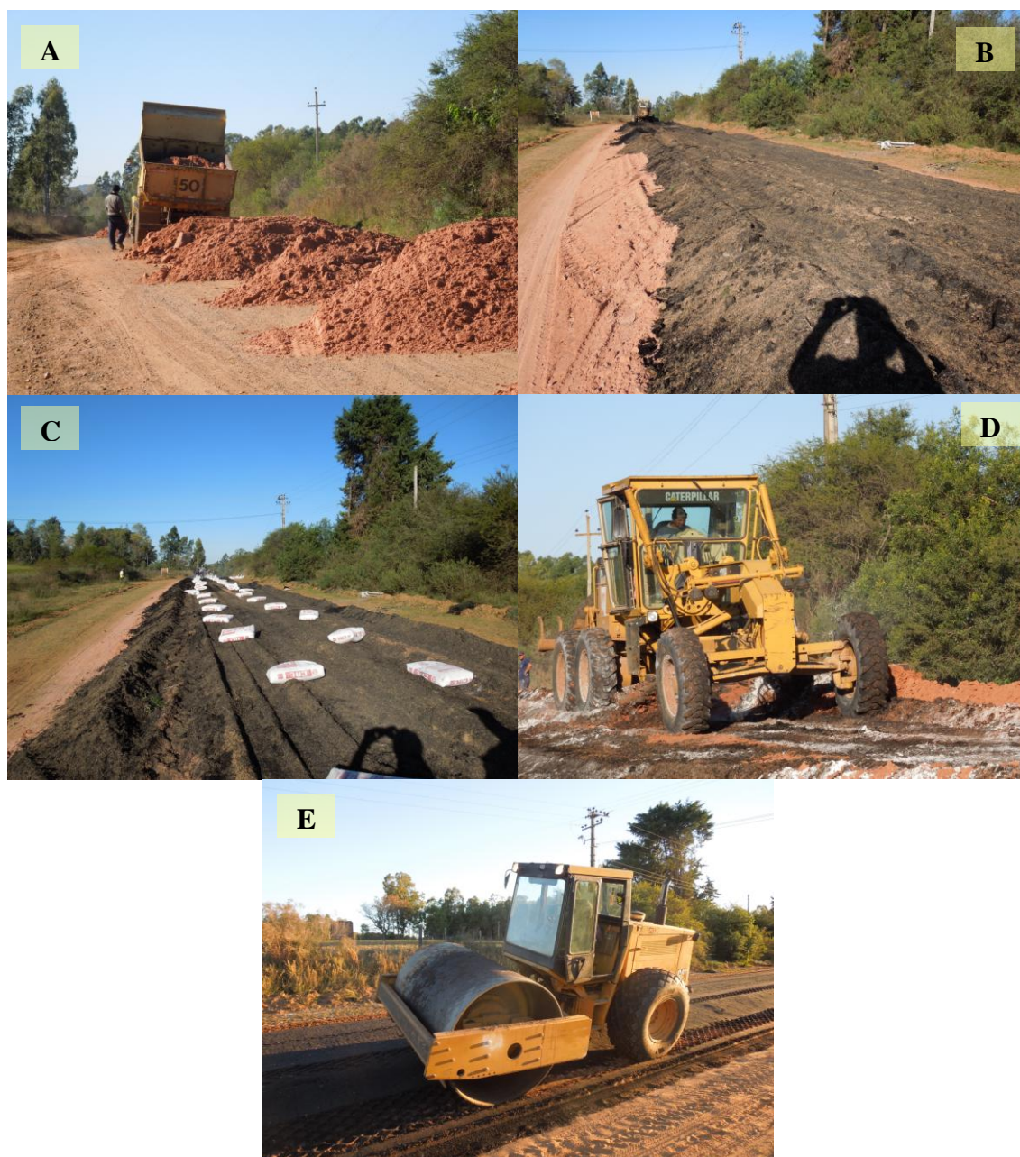
Figura 5.12. Etapas de Construcción del Tramo Experimental con Capa de Recargo del Camino a la Piedra Pintada
