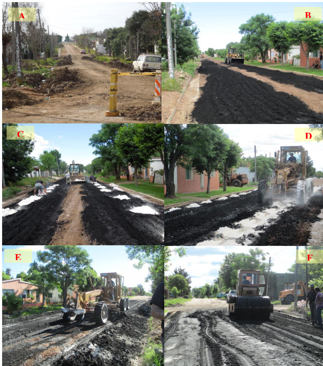
Figura 4.8. Etapas de Construcción del Tramo Experimental de la Calle Melo de Bella Unión
