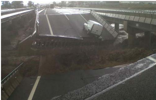
Derrumbe de puente en autopista A7 en España.
