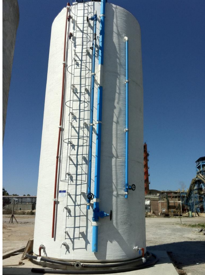
Figura 3 Reactor de 100 m 3 ubicado en la planta de ALUR Bella Unión.
