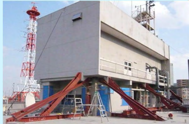
Planta de Sendai Edificio dañado
