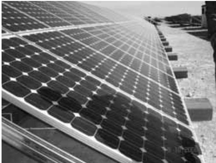
Instalación solar con paneles fijos
