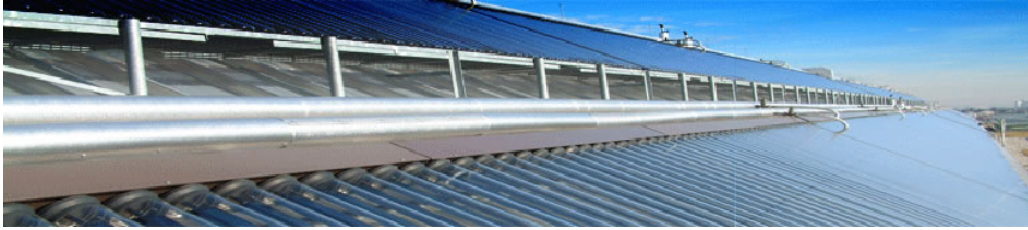
Figura 3.13: Colectores con tubos evacuados.
