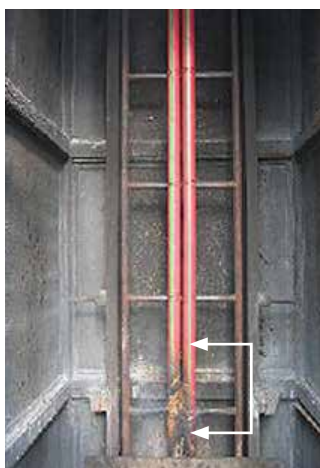
Longitud afectada por el fuego inferior a 2 m.
