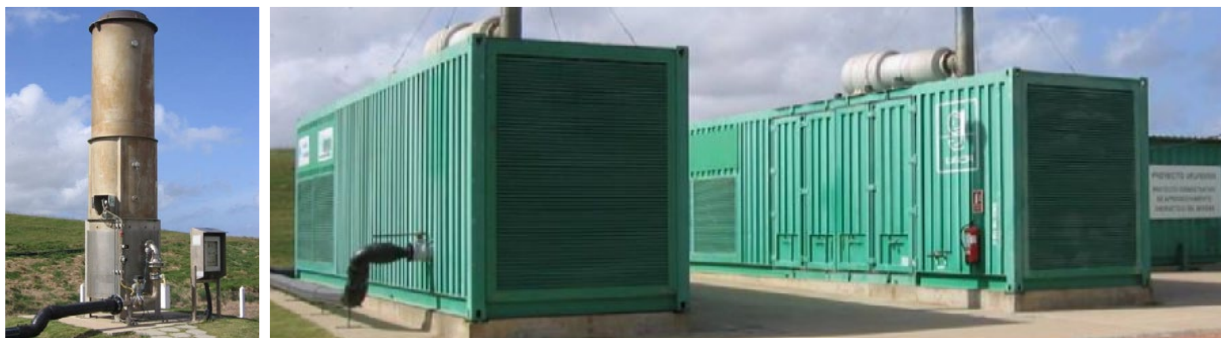
Ilustración 5: Generadores de electricidad a partir de biogás y antorcha en SDF Las Rosas
