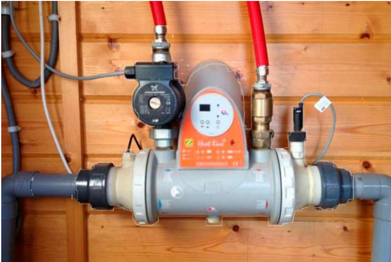
Intercambiador de calor para calentar agua de piscina
